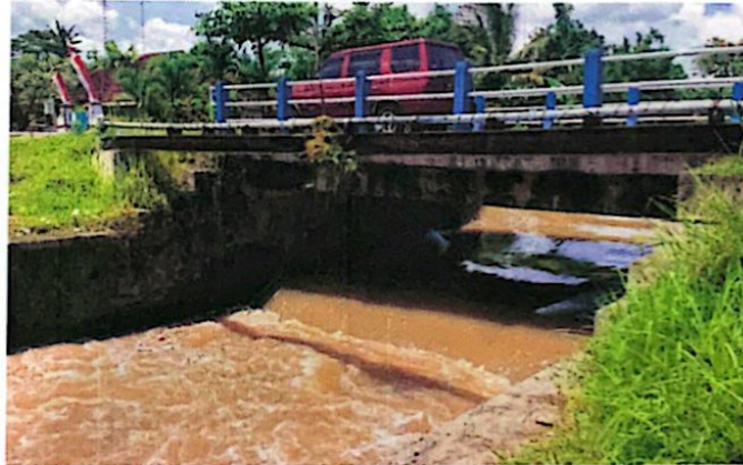
Gambar 6 : Kondisi eksisting pipa lama di saluran primer lodagung
