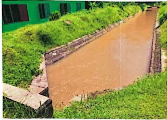
Gambar 5 : Kondisi eksisting pipa lama di saluran tersier
