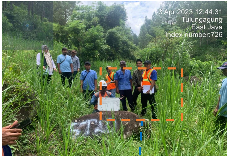
STA 0+00 Pengadaan dan Pemasangan Pipa Transmisi GI 350 mm (expose) - NUWSP Connecting Broncaptering - DDUB
