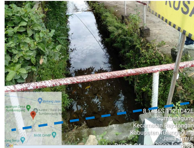
Pipa Ø 160 mm expose di Saluran SDA Dinas PUPR Kabupaten.
