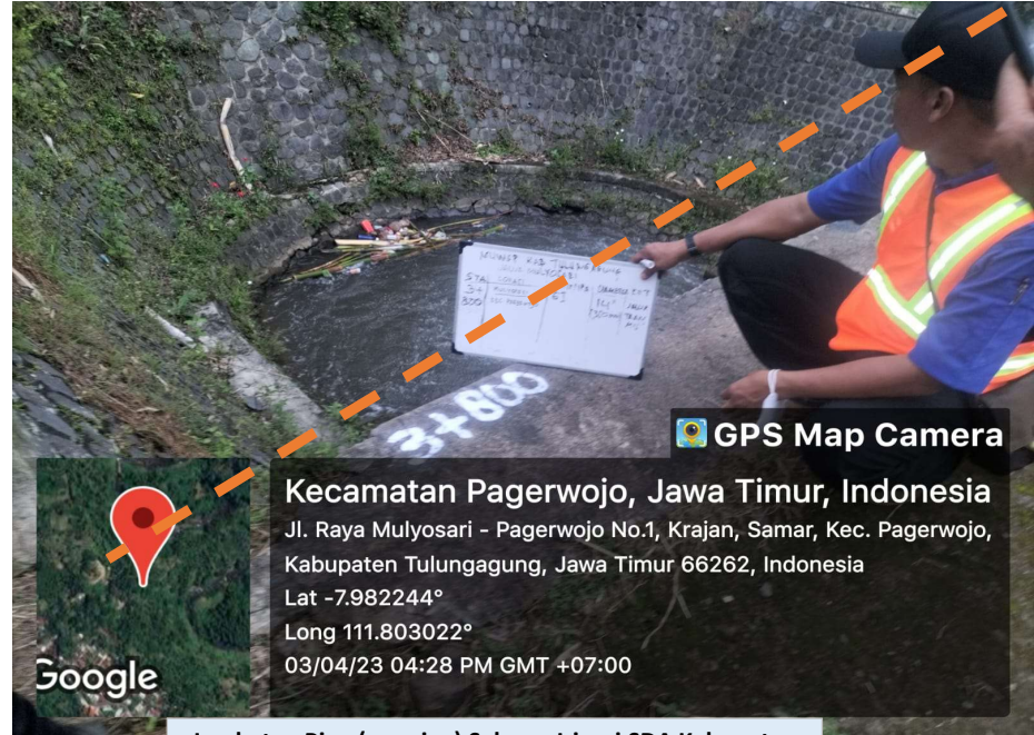
Jembatan Pipa (crossing) Saluran Irigasi SDA Kabupaten
