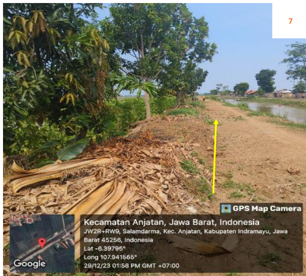
Rencana : Pemasangan Pipa JDU HDPE Ø 200 mm Jalan Irigasi Salam Darma (-6.39795,107.941565) 0+300 Metode : Open cut Keterangan : Aman, Tidak ada utilitas
