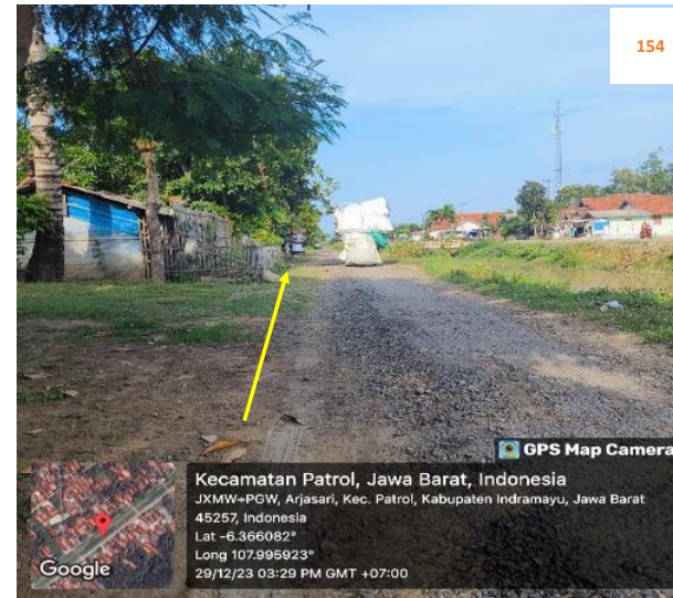
Rencana : Pemasangan Pipa JDU HDPE Ø 200 mm Jalan irigasi Arjasari (-6.366082,107.995923) 7+650 Metode : Open Cut Keterangan : jalan aspal
