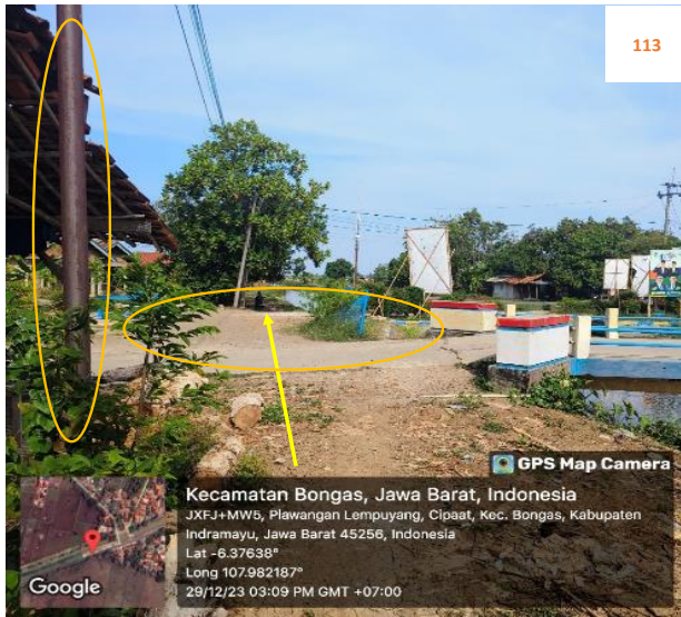
Rencana : Pemasangan Pipa JDU HDPE Ø 200 mm Jalan irigasi Cipaat (-6.37638,107.982187) 5+600 Metode : Open Cut, Crossing, Syphon - 3 m Keterangan : Tiang Telpon, jalan beton ,pintu air, gorong-gorong air
