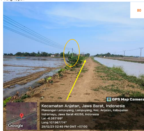
Rencana : Pemasangan Pipa JDU HDPE Ø 200 mm Jalan Irigasi lempuyang (-6.382189,107.967774) 3+950 Metode : Open Cut Keterangan : Tiang Telpon
