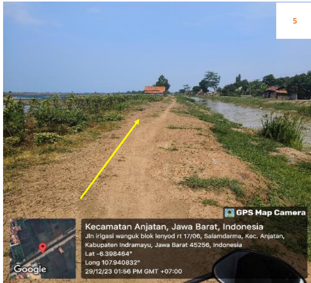
Rencana : Pemasangan Pipa JDU HDPE Ø 200 mm Jalan Irigasi Salam Darma (-6.398464,107.940832) 0+200 Metode : Open cut Keterangan : Aman, Tidak ada utilitas
