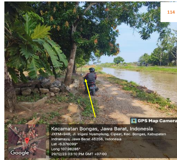
Rencana : Pemasangan Pipa JDU HDPE Ø 200 mm Jalan irigasi Cipaat (-6.376099,107.98285) 5+650 Metode : Open Cut Keterangan : Aman, Tidak ada utilitas
