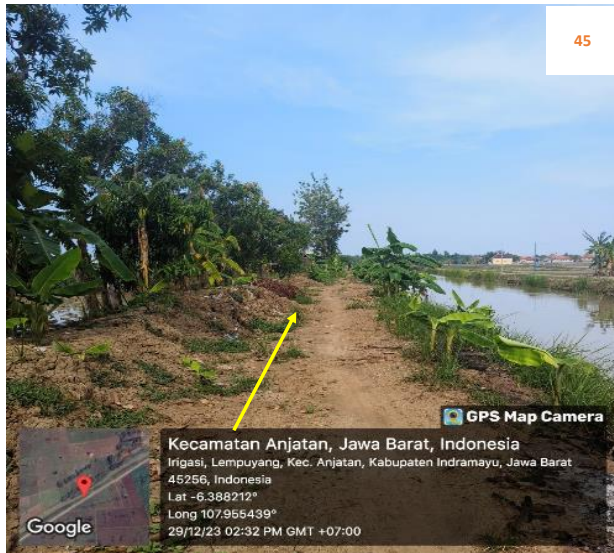
Rencana : Pemasangan Pipa JDU HDPE Ø 200 mm Jalan Irigasi lempuyang (-6.388212,107.955439) 2+200 Metode : Open Cut Keterangan : Aman, Tidak ada utilitas
