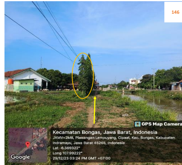
Rencana : Pemasangan Pipa JDU HDPE Ø 200 mm Jalan irigasi Cipaot (-6.369322,107.99222) 7+250 Metode : Open Cut Keterangan : pohon
