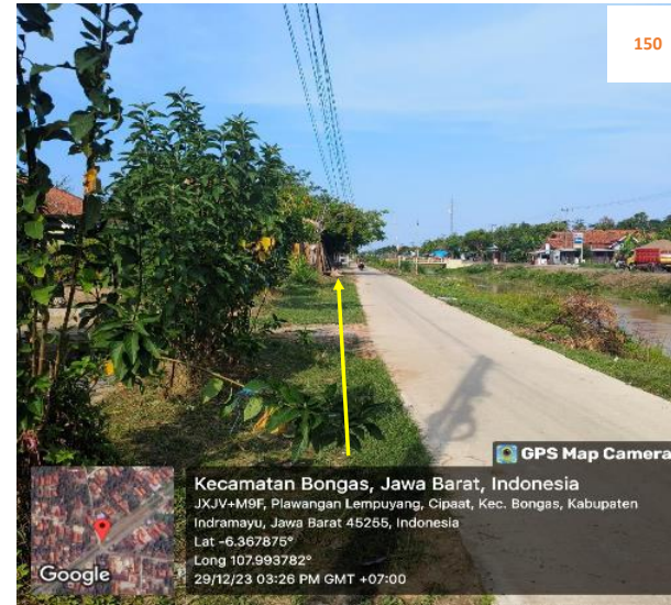
Rencana : Pemasangan Pipa JDU HDPE Ø 200 mm Jalan irigasi Cipaat (-6.367875,107.993782) 7+450 Metode : Open Cut Keterangan : rumah warga, jalan beton
