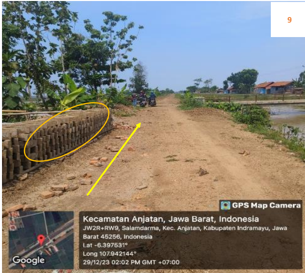
Rencana : Pemasangan Pipa JDU HDPE Ø 200 mm Jalan Irigasi Salam Darma (-6.397531,107.942144) 0+400 Metode : Open Cut Keterangan : Pembuatan Bata Merah
