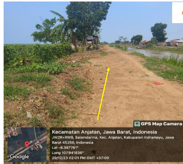
Rencana : Pemasangan Pipa JDU HDPE Ø 200 mm Jalan Irigasi Salam Darma (-6.397761,107.941836) 0+350 Metode : Open Cut Keterangan : Aman, Tidak ada utilitas
